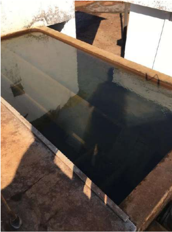
Foto 3.9 – Detalhe do filtro
