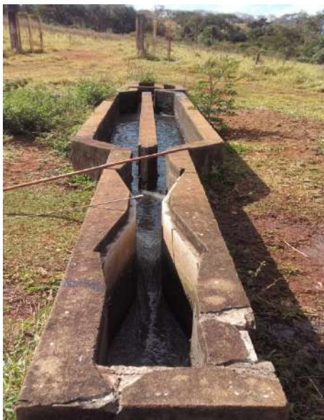
Foto 3.22 – Detalhe da caixa de areia e da calha Parshall
