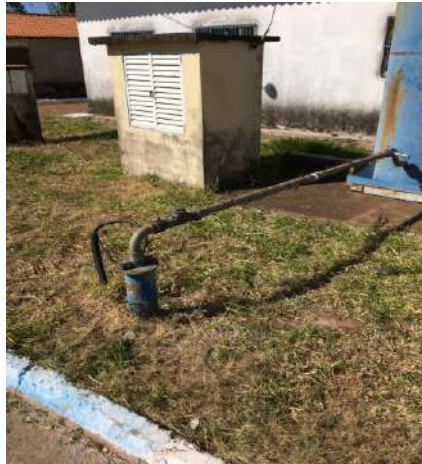
Foto 3.17 – Detalhe do Poço Profundo Buritizinho
