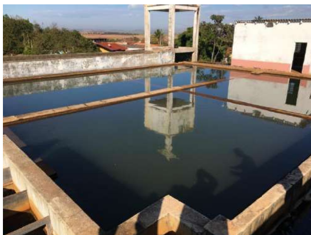
Foto 3.7 – Vista Geral da ETA.
