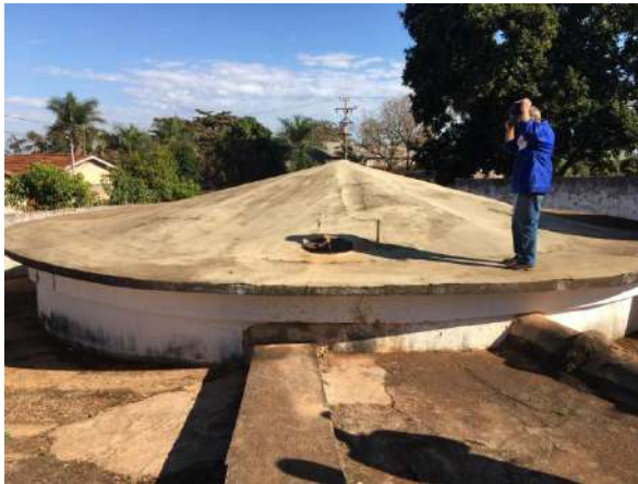
Foto 3.11 – Vista do reservatório enterrado
