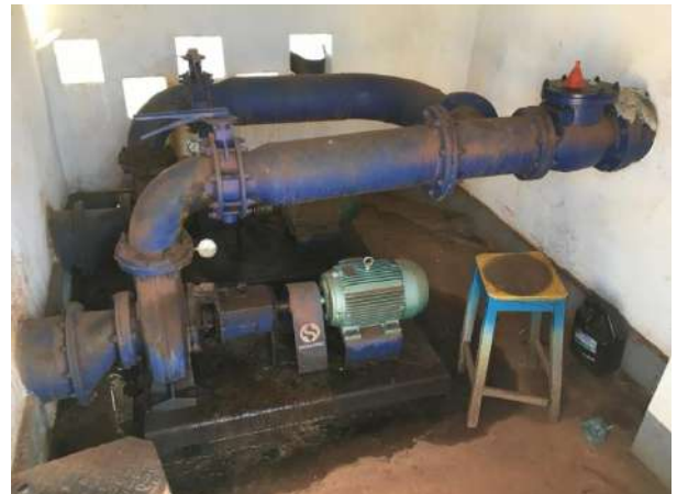
Foto 3.16 – EEAT-1 – Detalhe dos conjuntos motobomba da EEAT da ETA
