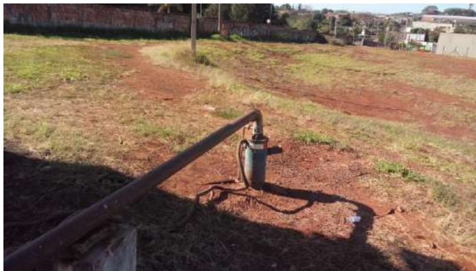
Foto 3.3 – Poço Profundo Primavera
