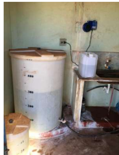
Foto 3.4 – Detalhe do dosador de cloro localizado junto ao poço
