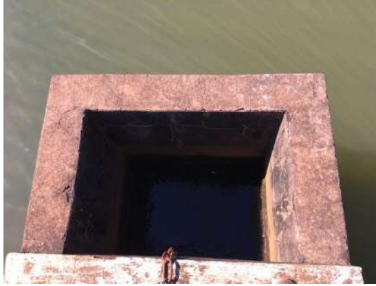
Foto 3.2 – Entrada da captação de água bruta
