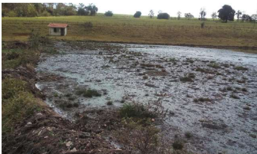
Foto 3.23 – Detalhe da lagoa anaeróbia em estado precário
