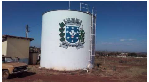
Foto 3.14 – Vista do reservatório apoiado metálico do Poliesportivo
