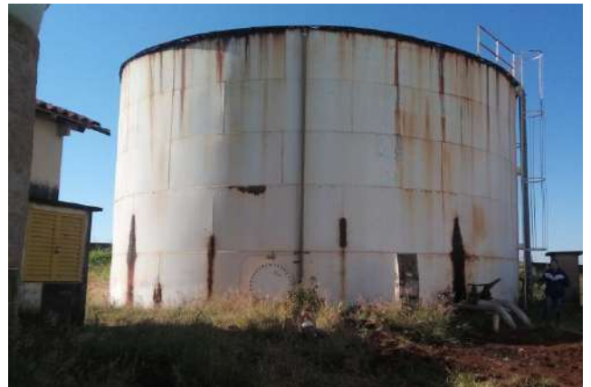
Foto 3.12 – Vista do reservatório apoiado metálico do Centro de Reservação da ETA
