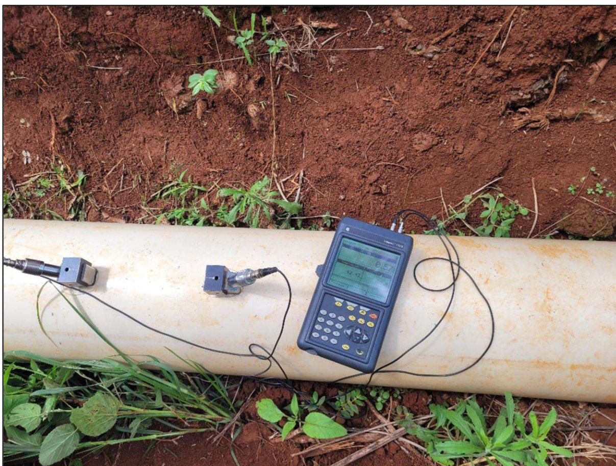
Figura 43: Detalhes do local de instalação do medidor ultrassônico - Ponto 6 de Vazão.
