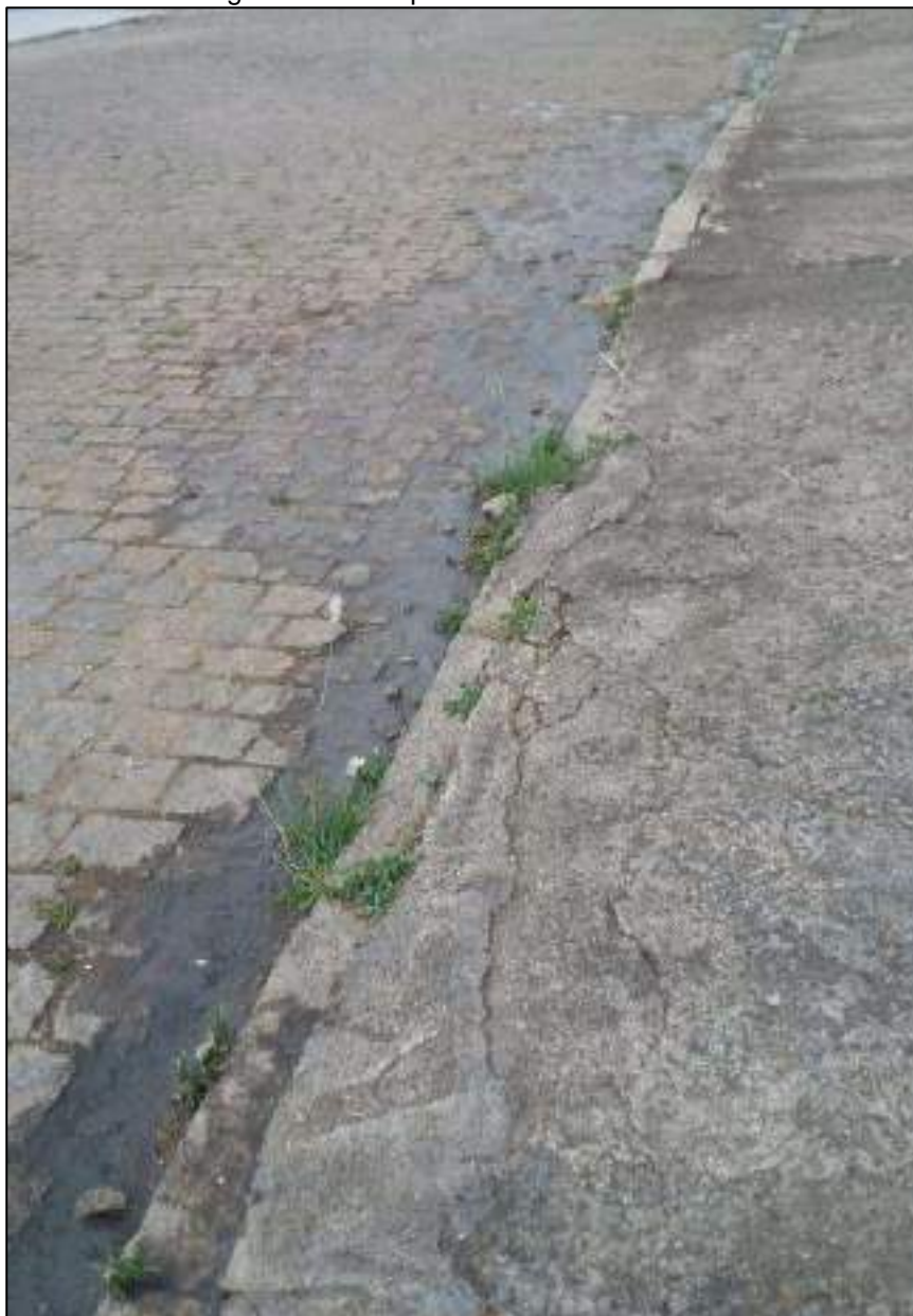
Figura 53: Exemplo de vazamento visível.
