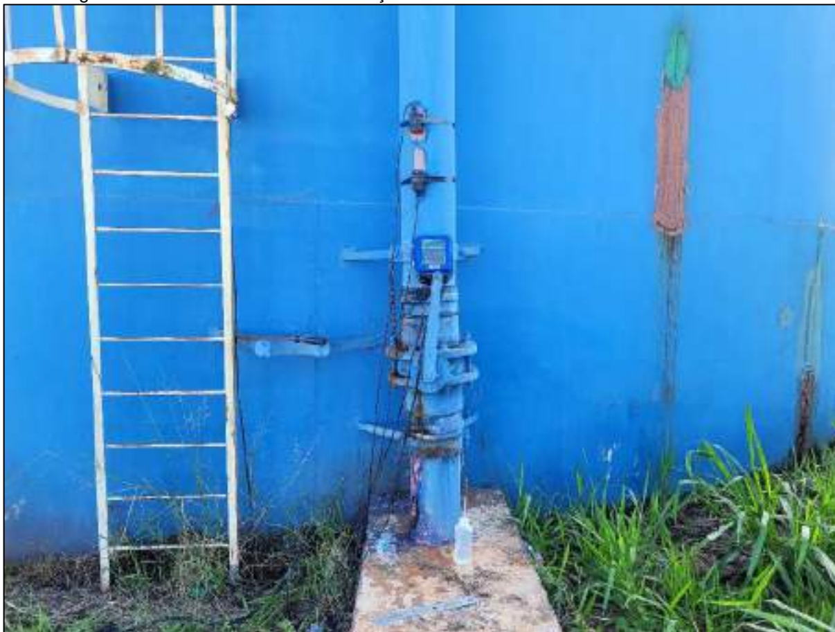
Figura 40: Detalhes do local de instalação do medidor ultrassônico - Ponto 5 de Vazão.
