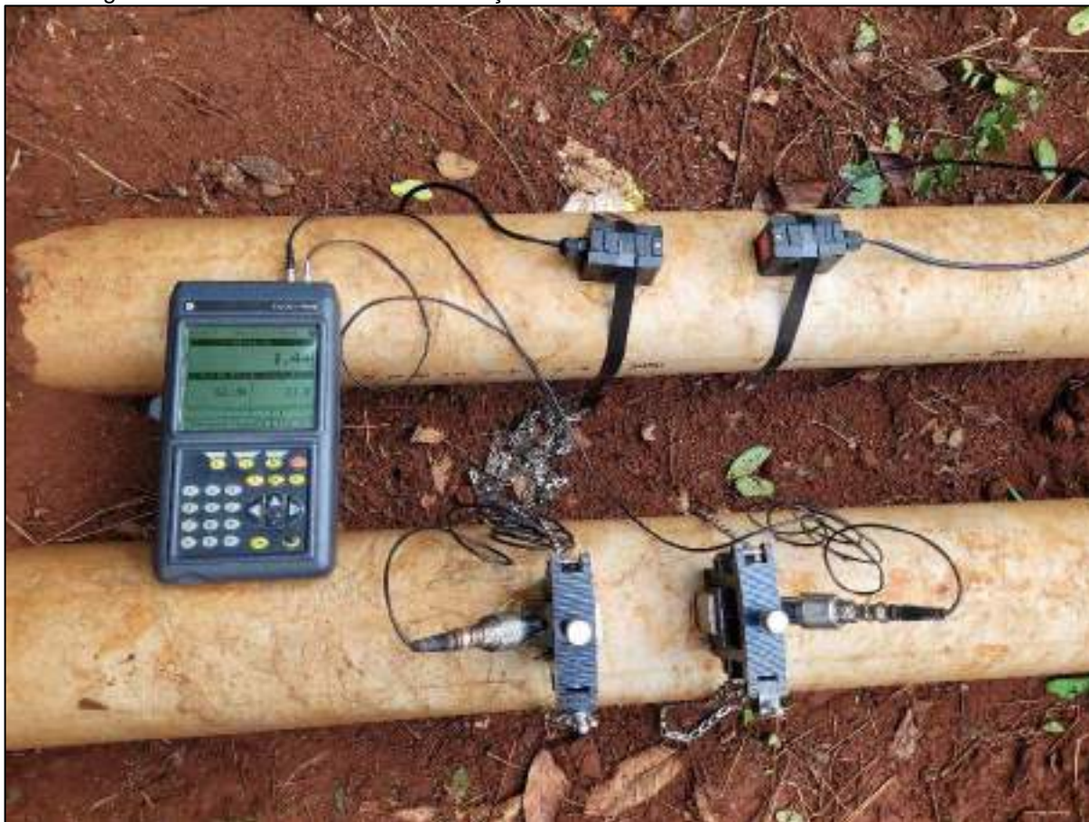
Figura 28: Detalhes do local de instalação do medidor ultrassônico - Ponto 1 de Vazão.
