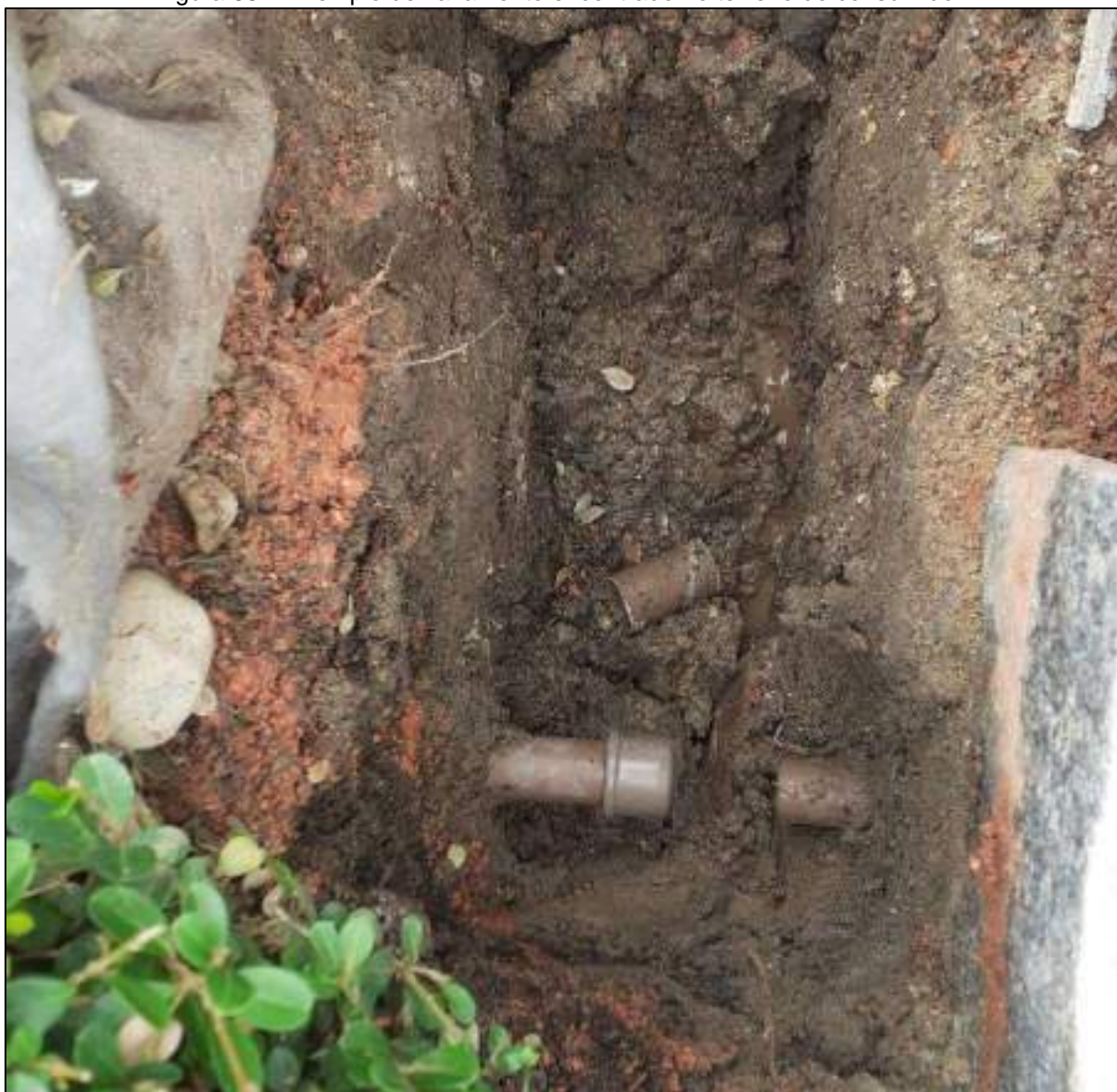
Figura 88 – Exemplo de vazamento encontrado no terreno do consumidor.
