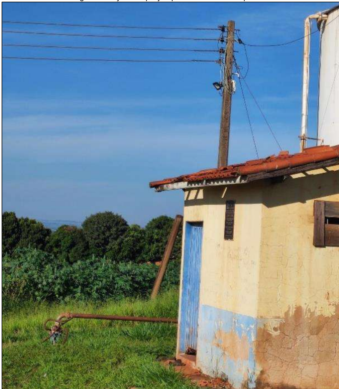
Figura 10: Reservatório apoiado Jardim Primavera 300m 3 e casa de química.
