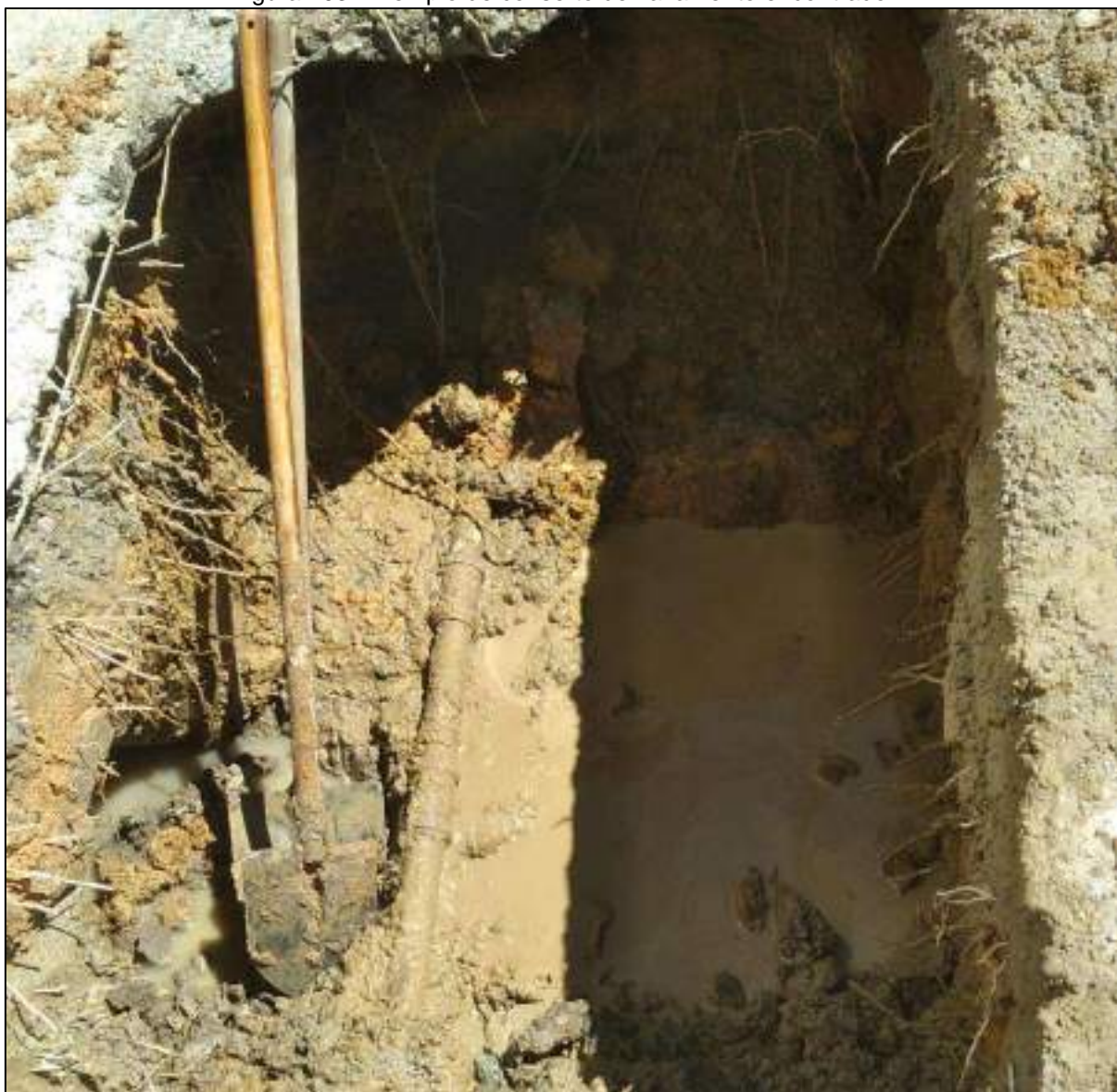
Figura 103: Exemplo de conserto de vazamento encontrado.
