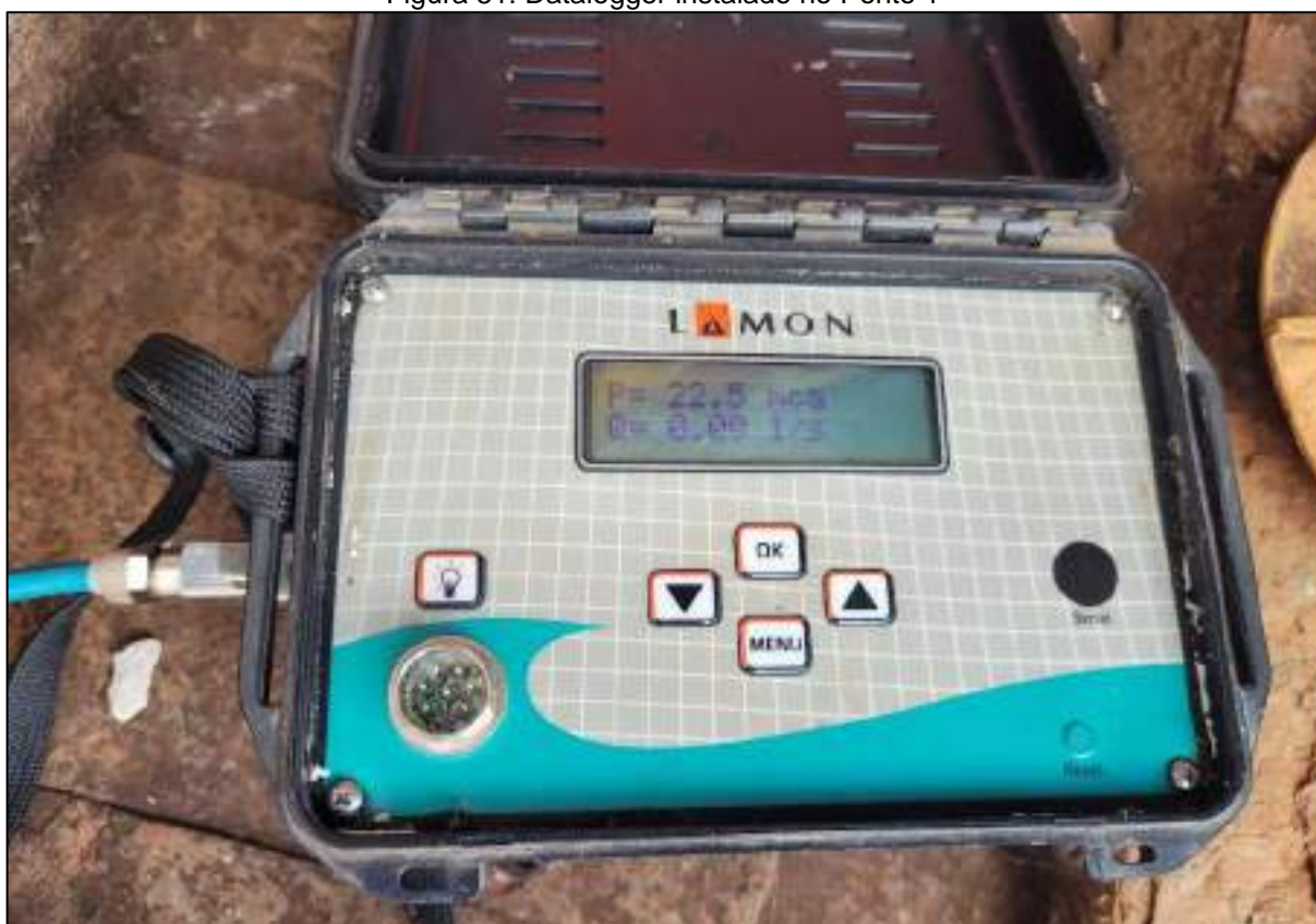
Figura 51: Datalogger instalado no Ponto 1
