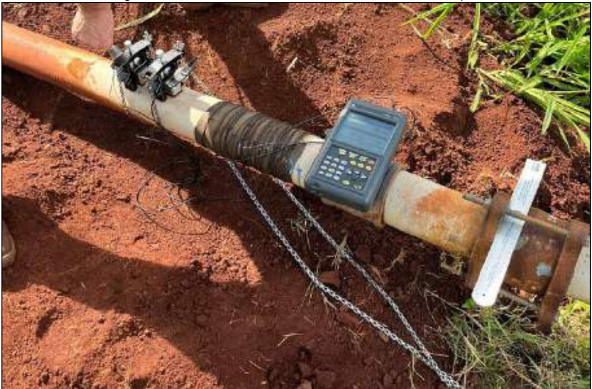
Figura 25: Tubo com medidor ultrassônico instalado em campo
