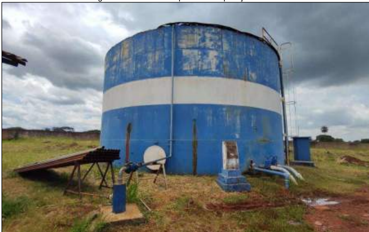
Figura 7: Reservatório apoiado em operação 800m 3 .
