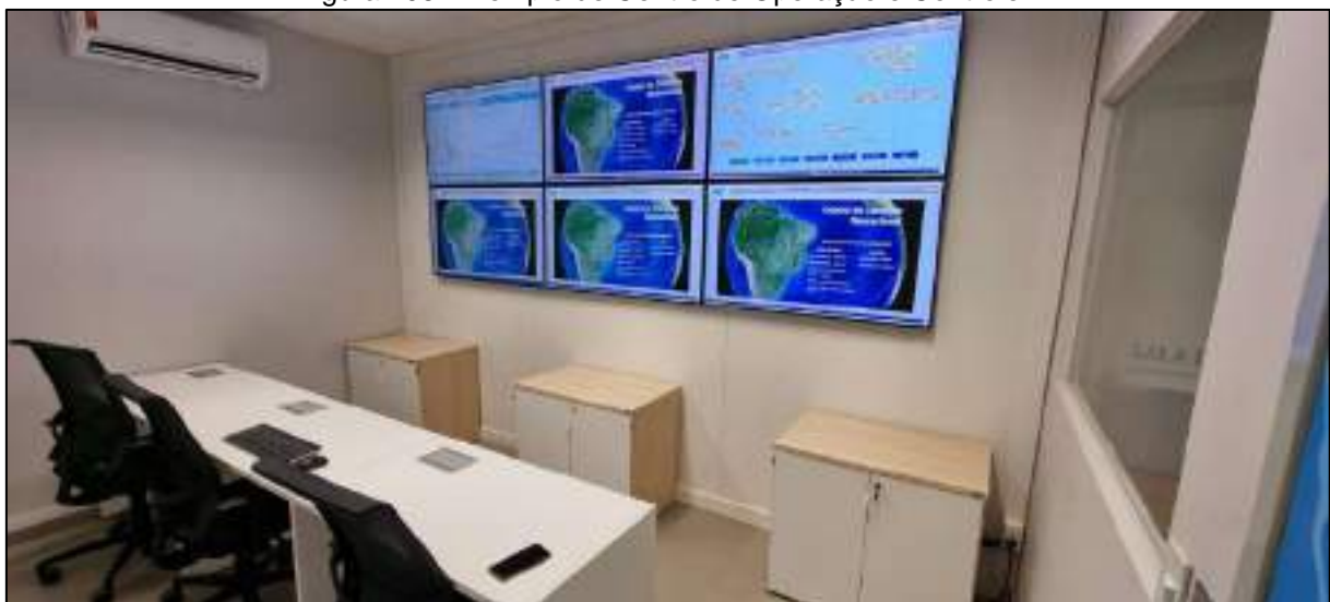
Figura 106: Exemplo de Centro de Operação e Controle.
