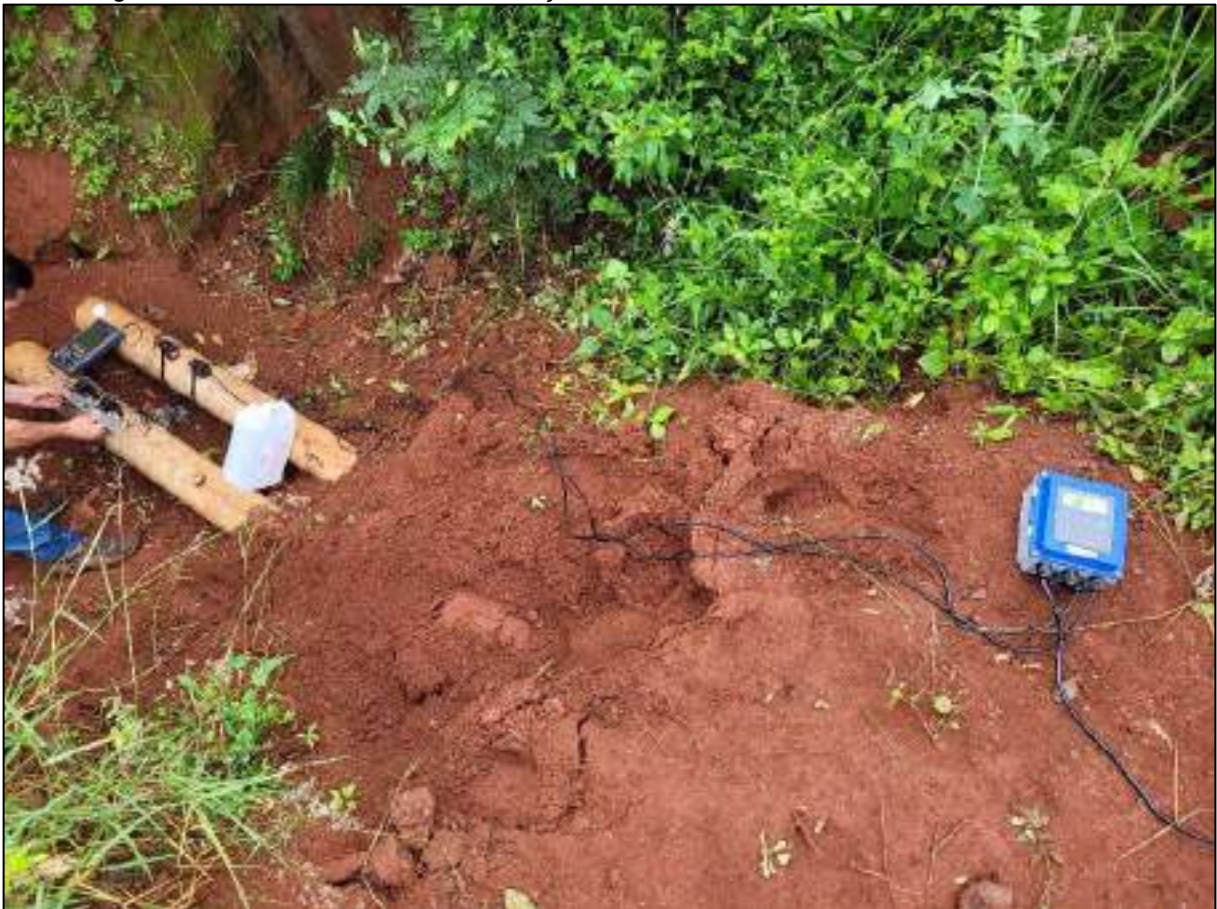
Figura 31: Detalhes do local de instalação do medidor ultrassônico - Ponto 2 de Vazão.
