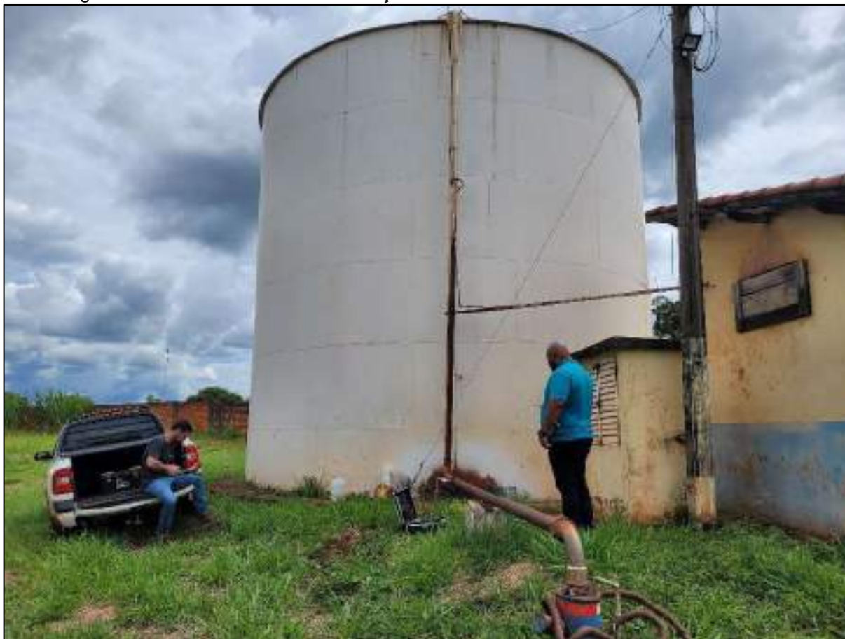
Figura 46: Detalhes do local de instalação do medidor ultrassônico - Ponto 7 de Vazão.
