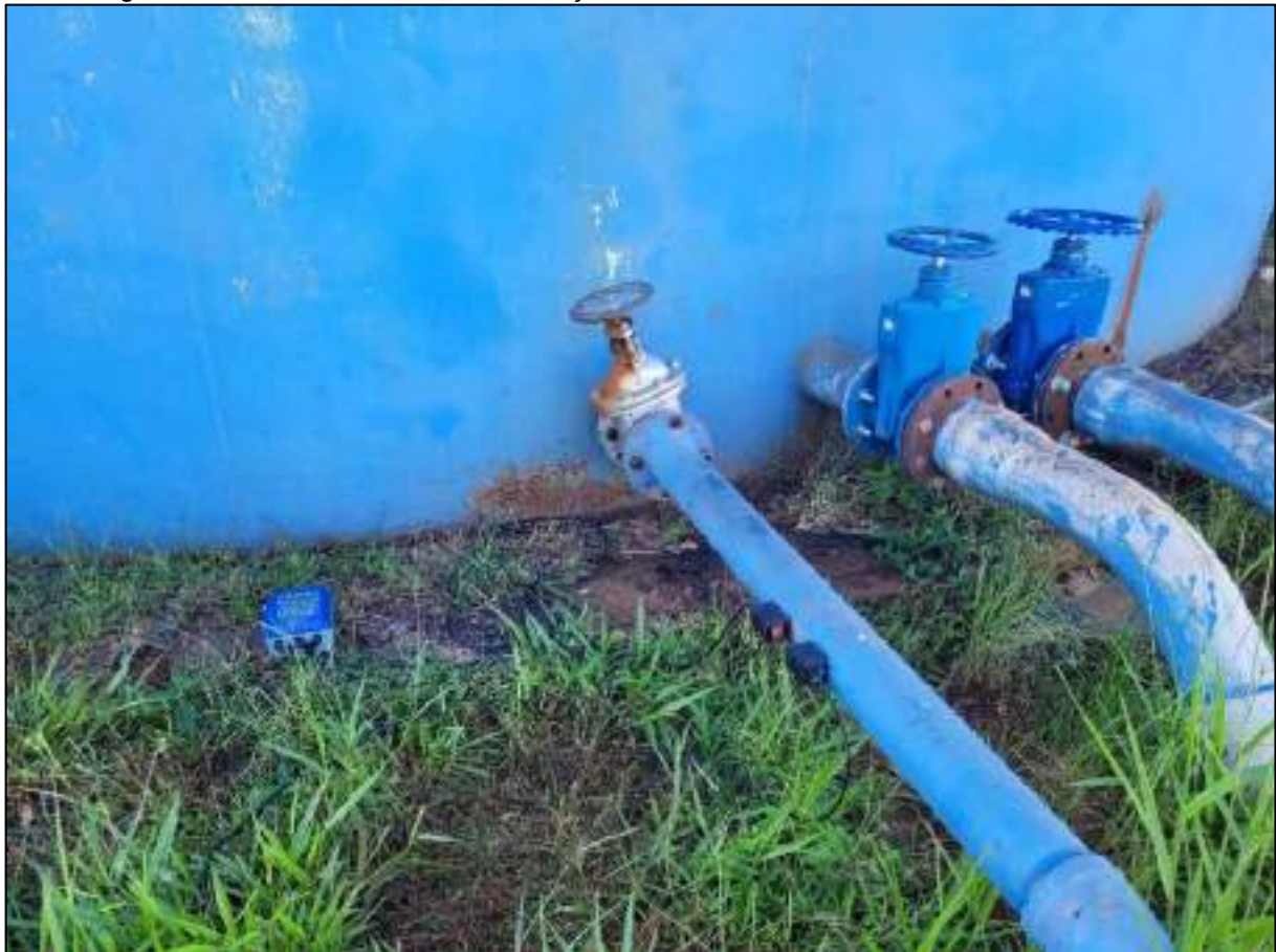
Figura 34: Detalhes do local de instalação do medidor ultrassônico - Ponto 3 de Vazão.
