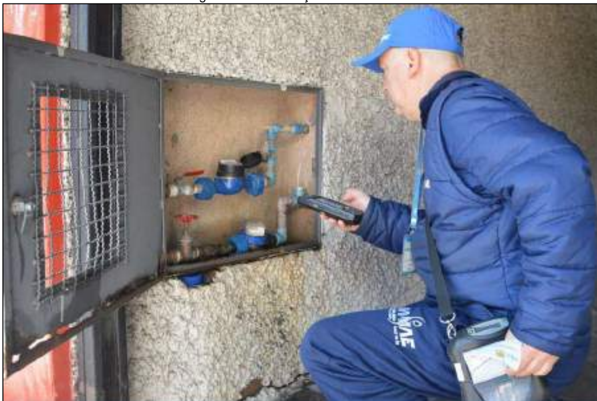
Figura 84 -Fiscalização de hidrômetro.
