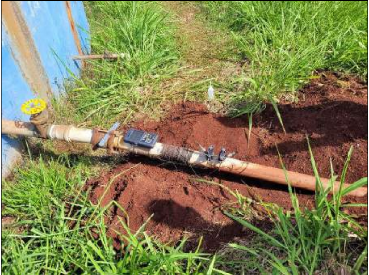
Figura 37: Detalhes do local de instalação do medidor ultrassônico - Ponto 4 de Vazão.
