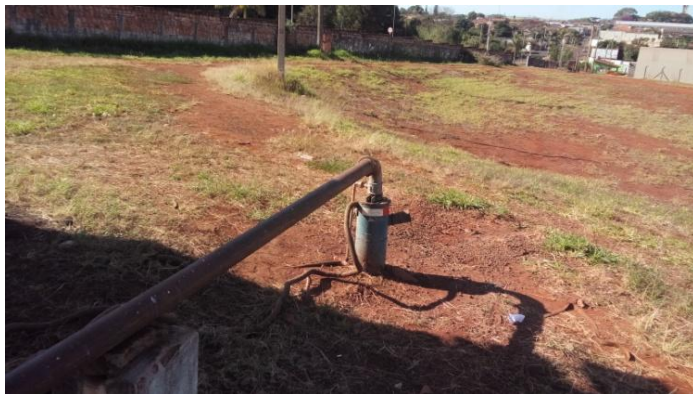
Foto 3.3 – Poço Profundo Primavera
