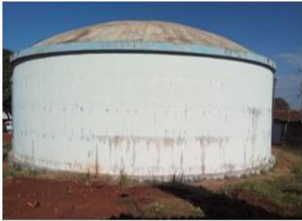
Vista da Reservatório Apoiado - ETA - Sede
