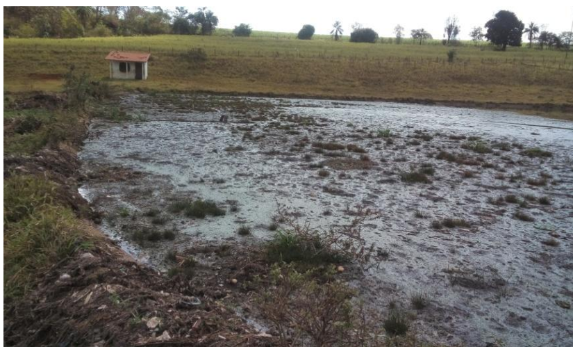
Foto 3.23 – Detalhe da lagoa anaeróbia em estado precário
