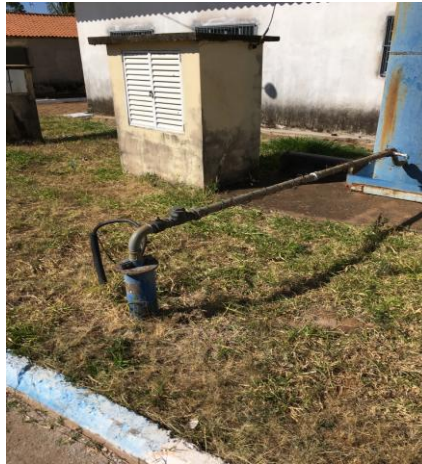
Foto 3.17 – Detalhe do Poço Profundo Buritizinho
