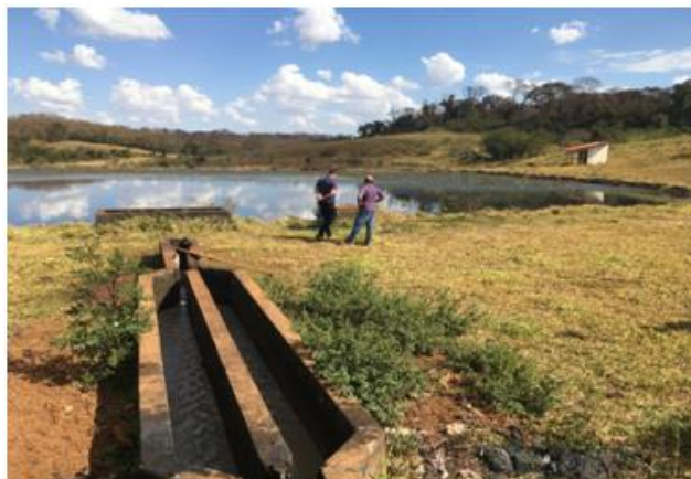
Detalhe da ETE de São José da Bela Vista
