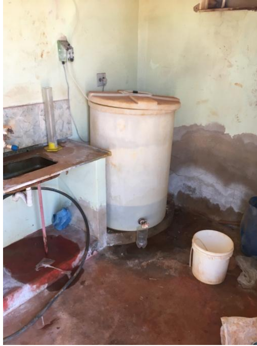
Foto 3.5 – Detalhe do dosador de flúor localizado junto ao poço
