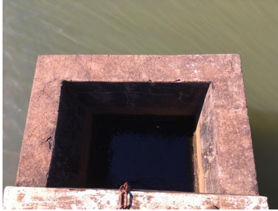
Foto 3.2 – Entrada da captação de água bruta
