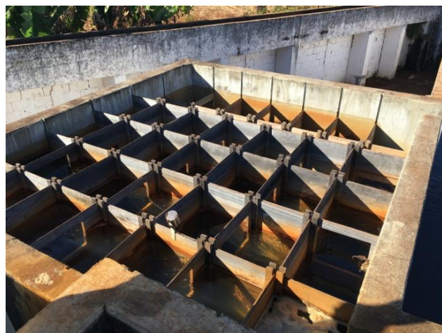
Foto 3.8 – Detalhe dos flocladores em chicanas de madeira
