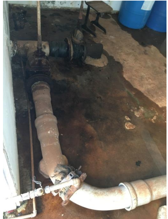
Foto 3.10 – Detalhe da tubulação de saída dos filtros para o reservatório pulmão
