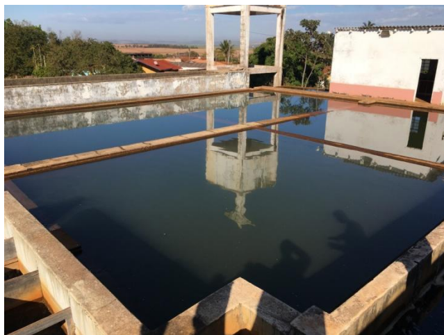
Foto 3.7 – Vista Geral da ETA.
